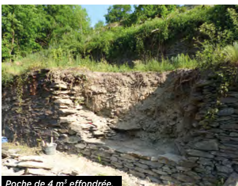
Poche de 4 m 3 effondrée.
